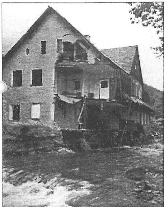
Jeden ze zniszczonych domów w Goworowie
